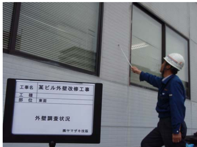
外壁タイル浮き調査状況 『黒板らく太郎』は色々な使い道があります
